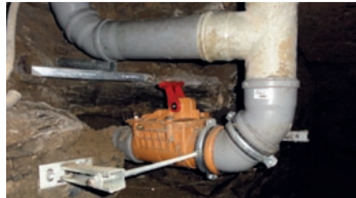
Abb. 7: Nachträglich eingebaute Rückstauklappe in historischem Einfamilienhaus – Leutesdorf am Rhein (FWW)
